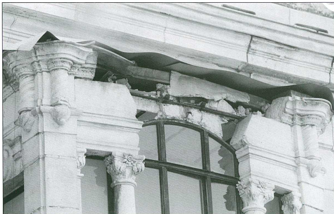
Les dégâts du temps, visibles sur cette image de 1994
